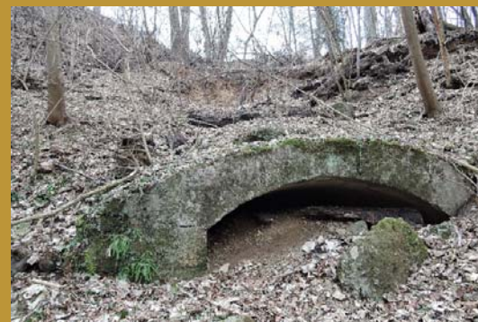
Verfallener Zugang, ④
